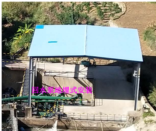
坝下回水泵站
